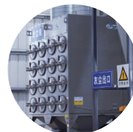
中央除尘系统
